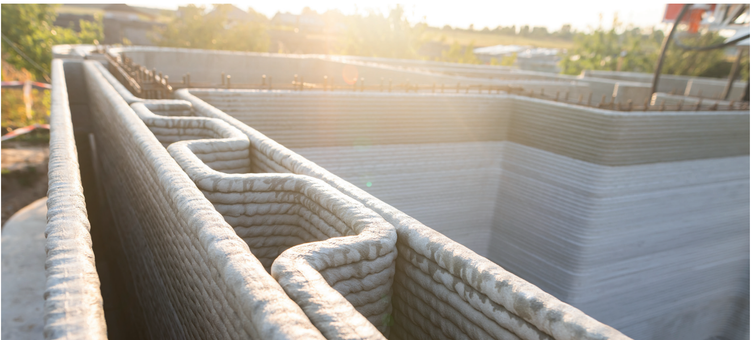
Pilotprojekt in Lünen: ein bedeutender Schritt in der Anwendung des 3D-Druckverfahrens im Bauwesen.
