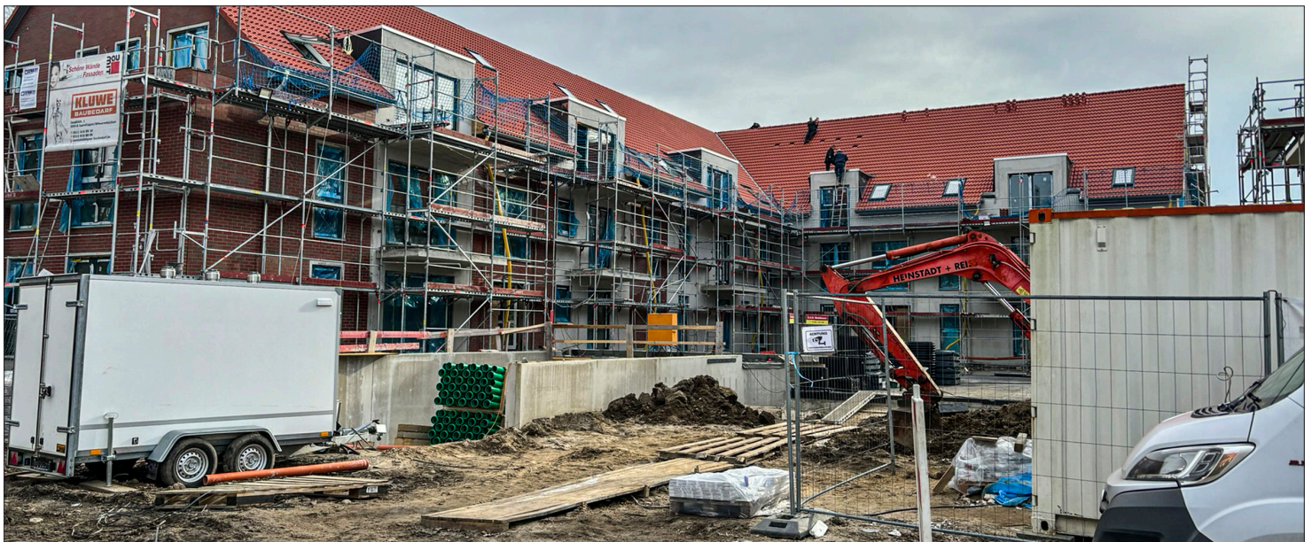
Nach Ablehnung der Baugenehmigung und Änderung der Vorgaben durch den Bauherren Die Baustelle an der „Laher Heide“ in Hannover-Bothfeld.
